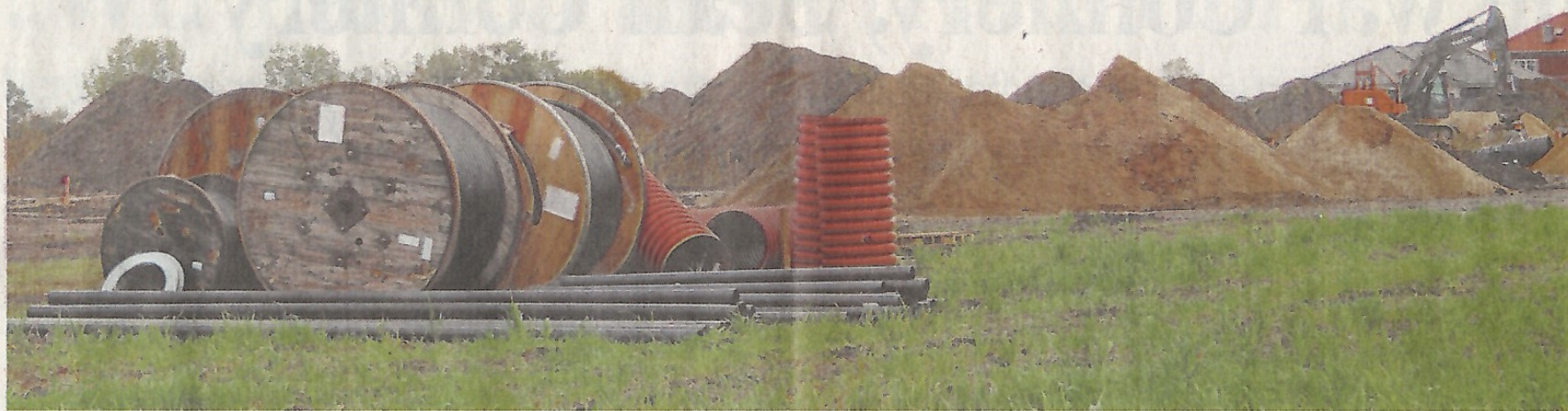
Die Erschließungsarbeiten im neuen Tülauper Baugebiet an der Hauptstraße sind in vollem Gang. Als Name wurde „Lübkesfeld“ festgelegt.
