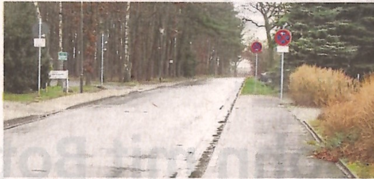
Das letzte Stück Rad- und Fußweg an der Schulstraße in Voitze soll saniert werden.
