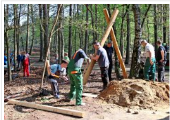
Arbeitseinsatz an der Waldschule Voitze: Eltern bauten eine Nestschaukel auf. Peter Zur
