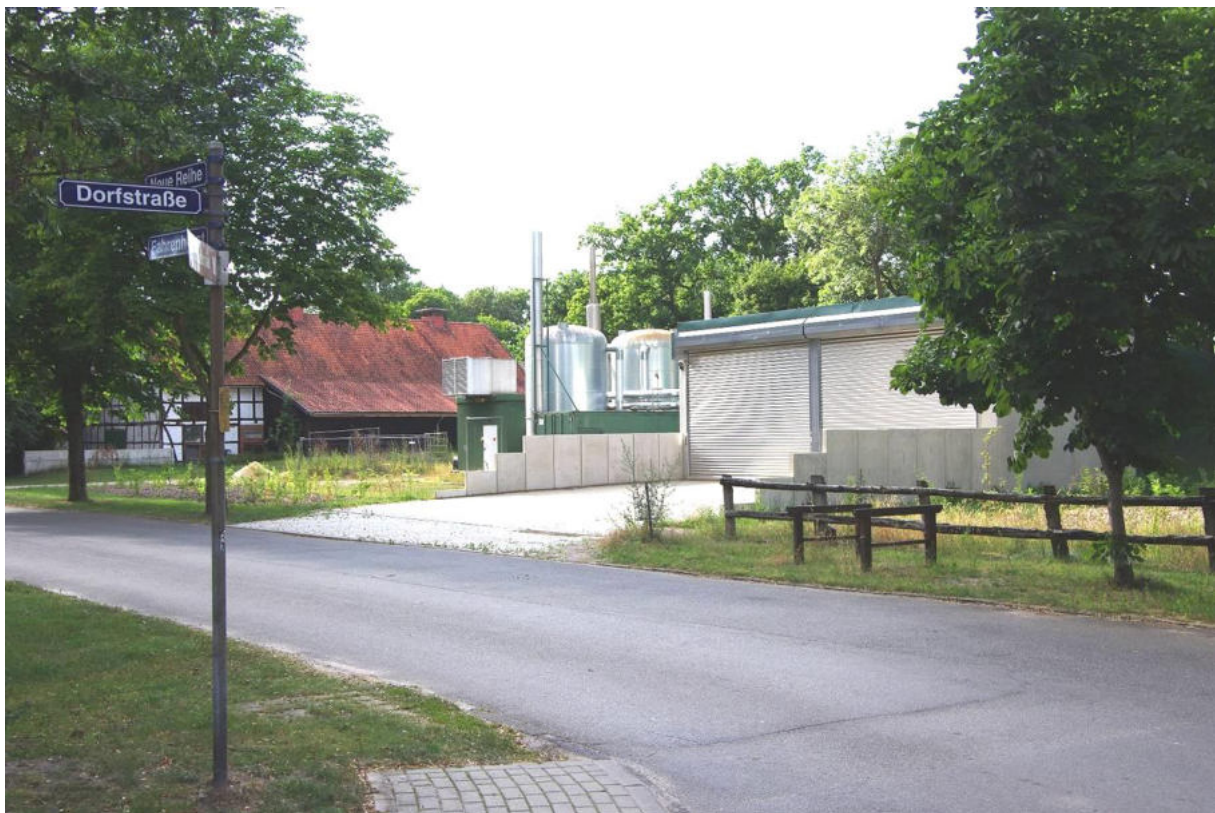
Das Blockheizkraftwerk (BHKW) im Ortskern von Tüla.
